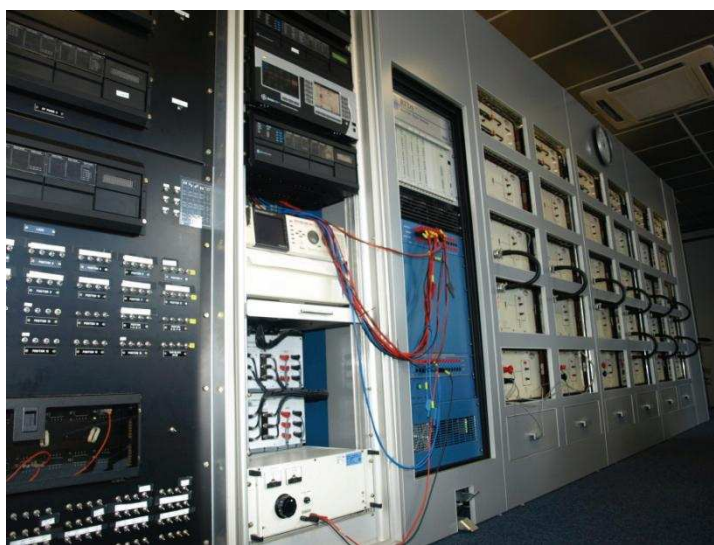
Рис. 4. Установка RTDS (Multilin, Бильбао, Испания)
